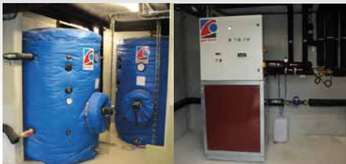
Chaufferie avec les 2 ballons de 2 000 L et la Solar Pump®
