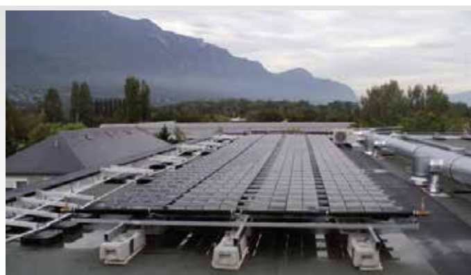
60 m 2 de captage POLYTUB « S » en toiture, qui capte aussi l'énergie de la pluie
