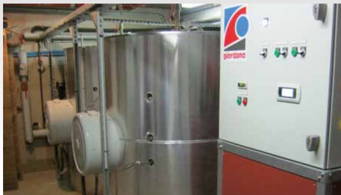
Chaufferie avec les 2 ballons de 2000 L et la Solar Pump
