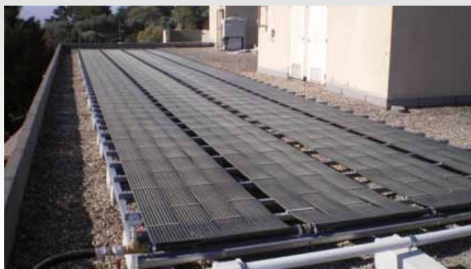
60 m 2 de captage POLYTUB « S » en toiture
